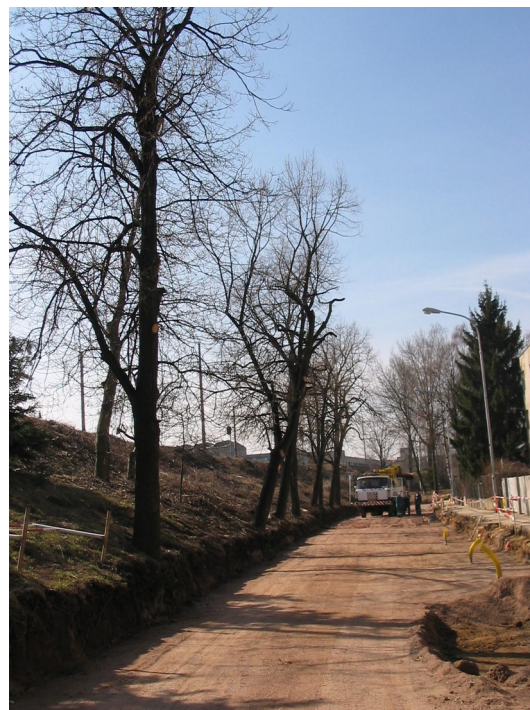
Obr. 38: Poškození KS výkopovými pracemi (foto M.Romanský)
