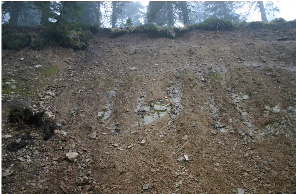
Stav svahu po epizodě sesuvu při kalamitním odlesnění. Stav před vybudováním opěrné zdi – Králický Sněžník rev. Malá Morava
