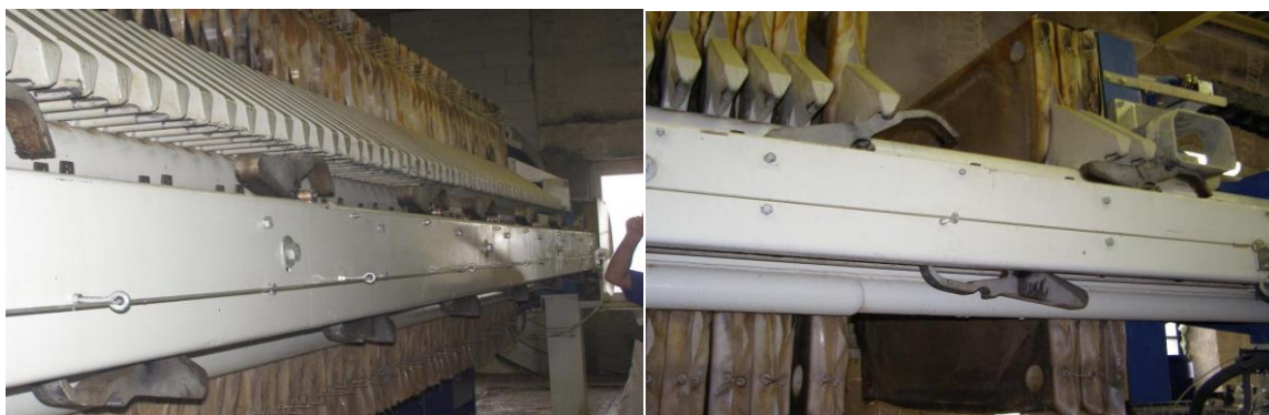
Obr. 91: Mechanizovaný kalolis při odstraňování kalu
