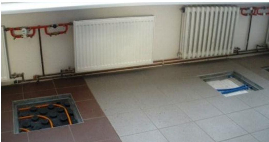
Vybavení laboratoře: podlahové vytápění, topná tělesa
