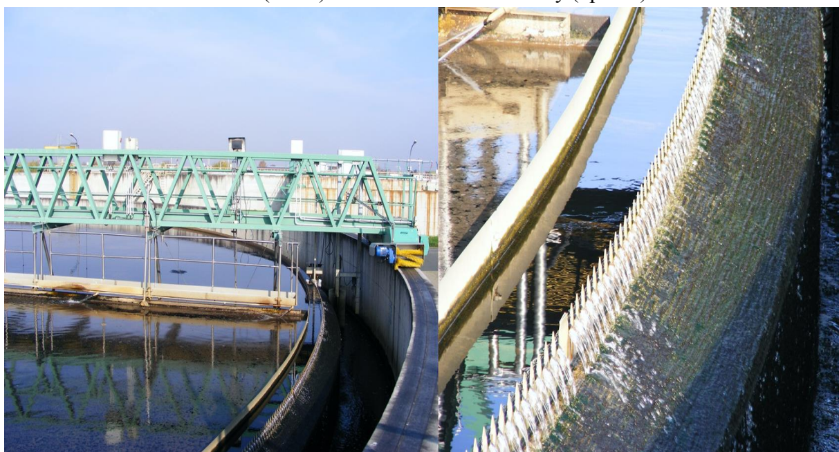
Obr. č. 47 Dosazovací nádrž (vlevo) s detailem odtokové hrany (vpravo)
