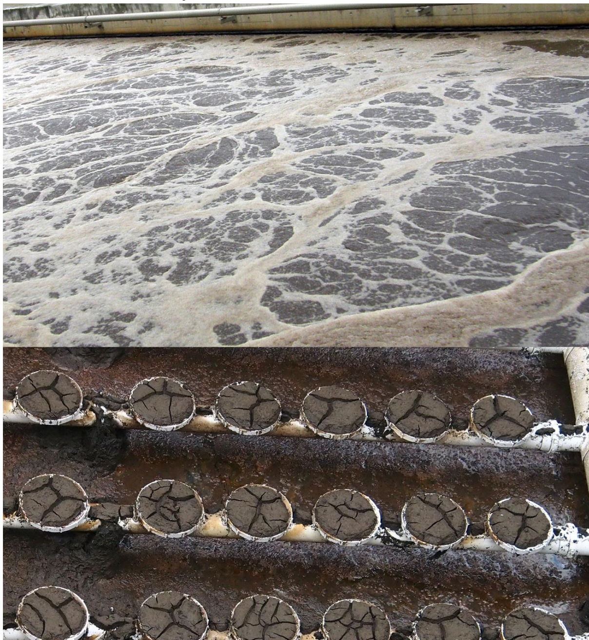
Obr. č. 45 Aktivační nádrž s jemnobublinnou aerací, dole detail aeračního zařízení
